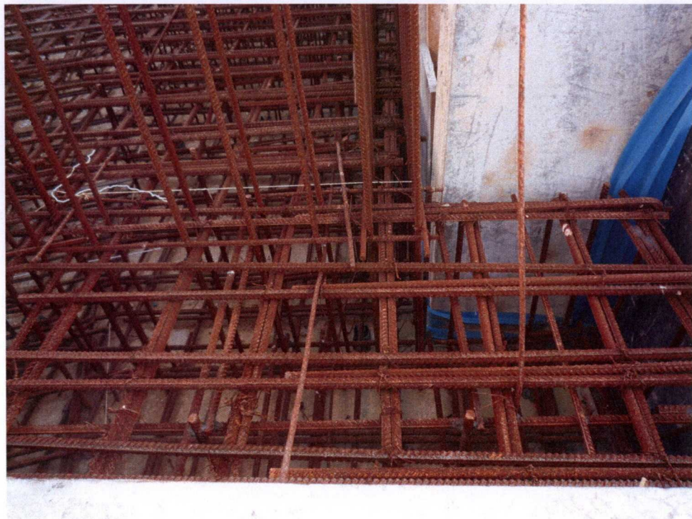
Фото № 4. Коррозия арматурного каркаса фундаментной плиты в секции 1.
